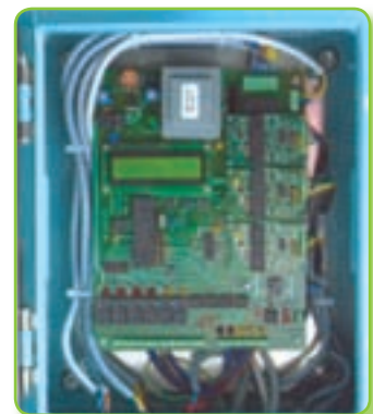
Σύνδεση για παρακολούθηση εξ' αποστάσεως
